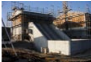
Zulaufhebewerk Kläranlage Griesheim
